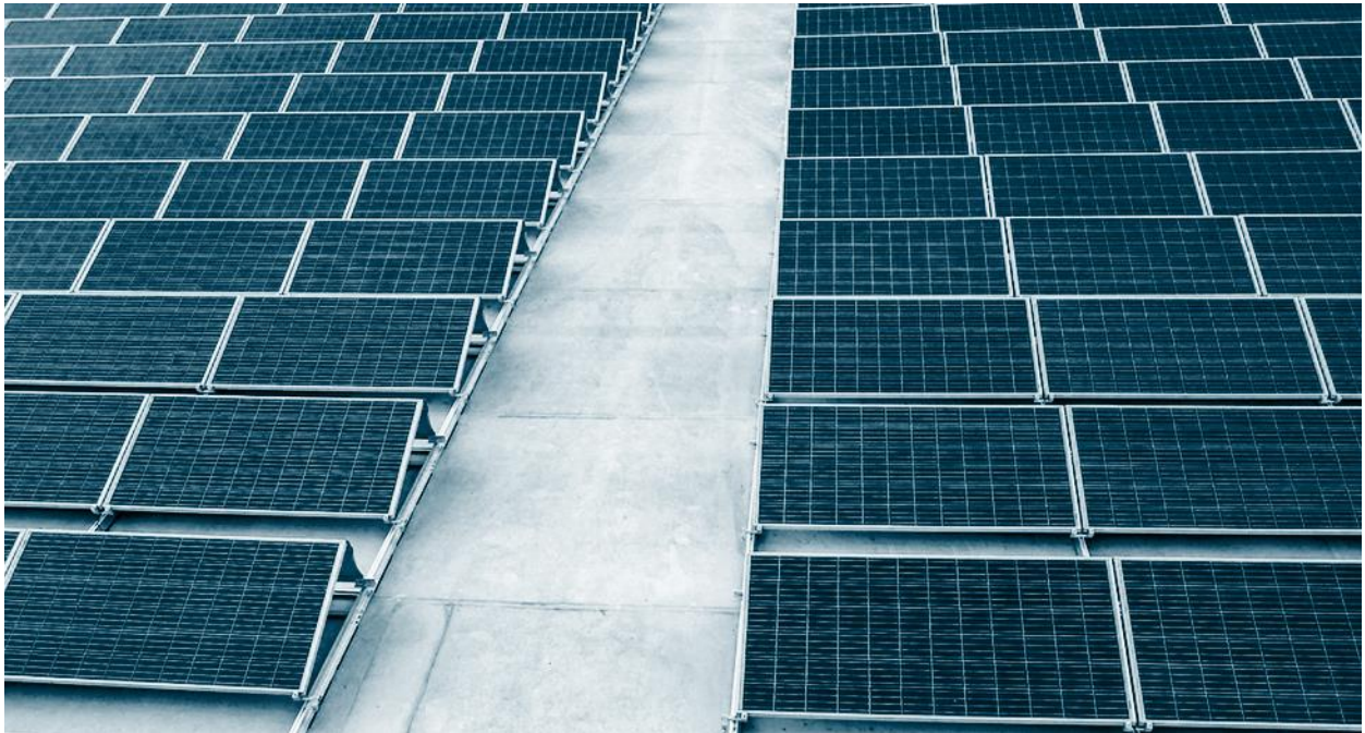
Abbildung 7: Nachhaltige und dezentralisierte Betreibermodelle – Mit Solar-Paneln bestücktes Gebäude
